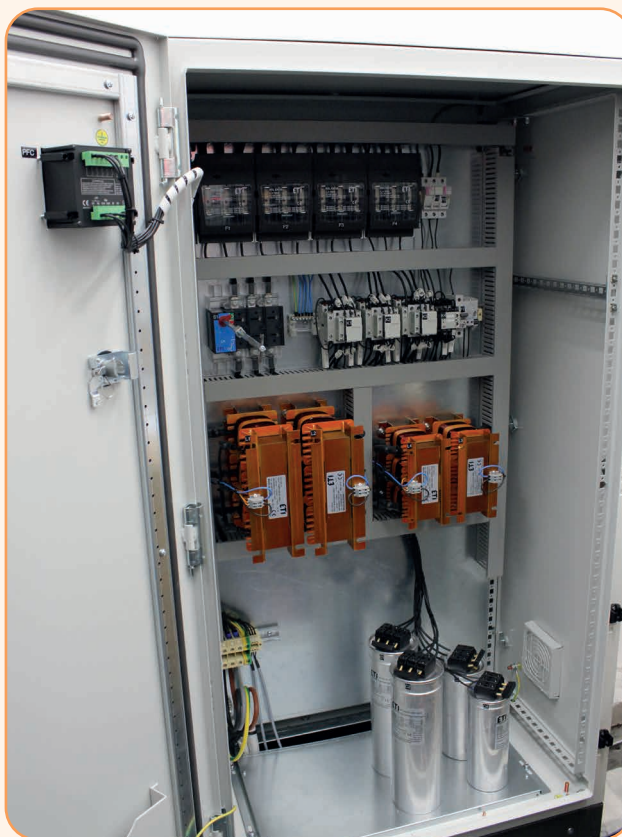
Rozdzielnica z baterią kondensatorów do kompensacji mocy biernej
